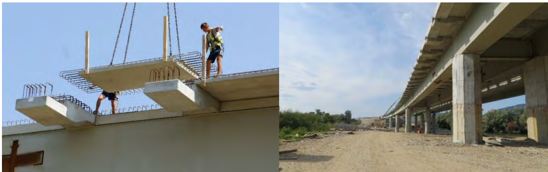
Figura 160. a) Dispunerea plăcilor prefabricate pe sistemul de grinzi intermediar, b) Structura podului finalizată
