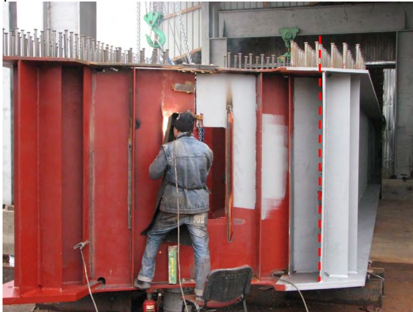
Figura 78. Deformații din sudură
