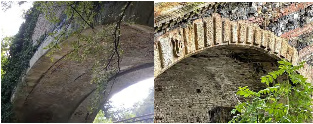
Figura 55. Câteva defecte constatate
