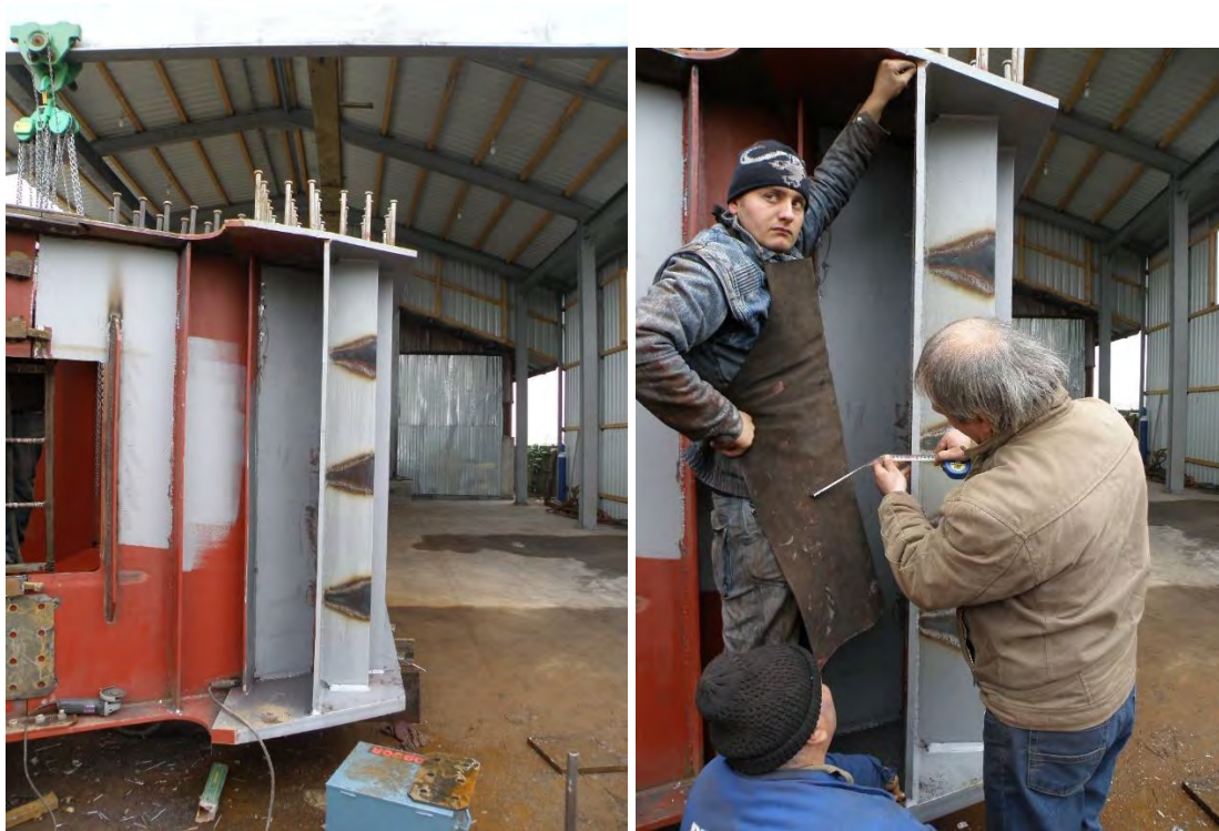
Figura 80. Aducerea în poziție a inimilor grinzilor principale Efortul a fost unul relevant în condițiile în care situația putea fi evitată.
